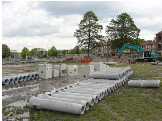
Nieuwe aanleg van gescheiden riolering in Parkweelde 2, een nieuwbouwproject van Amersfoort Vernieuwt
